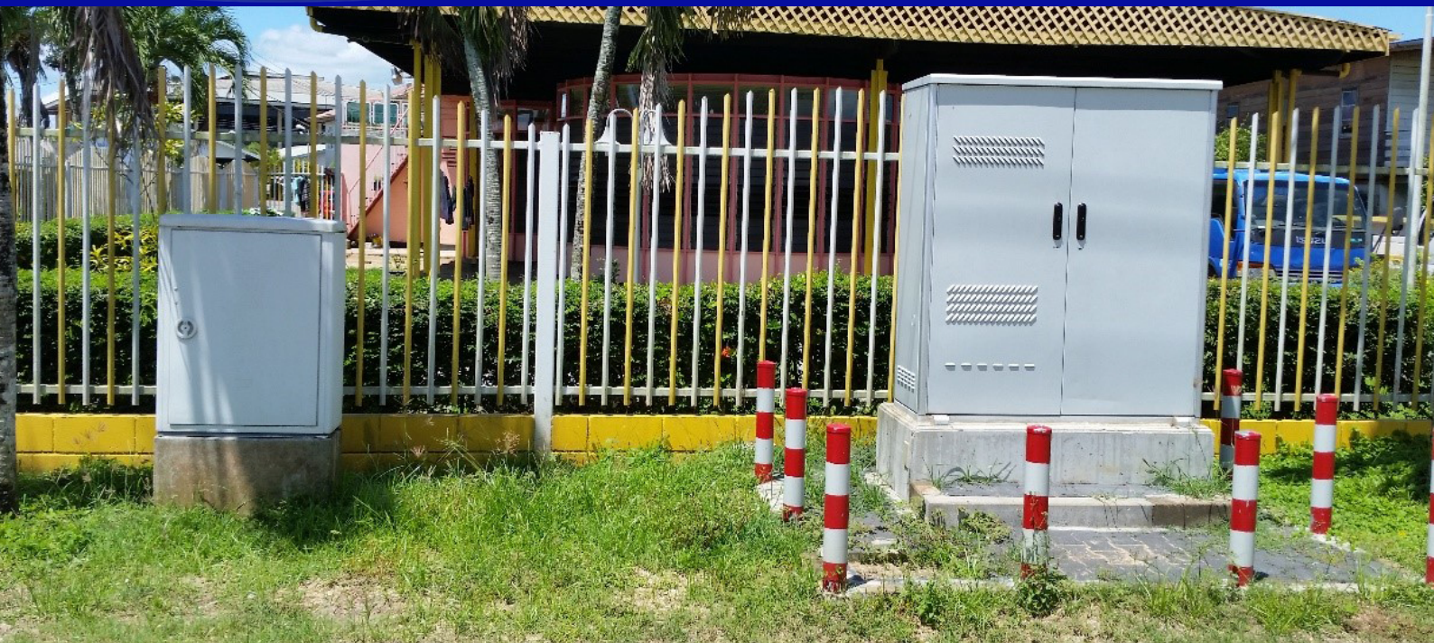
geïllustreerd een omgebouwde KVK en de MSAN kast oftewel de "mini centrale"
