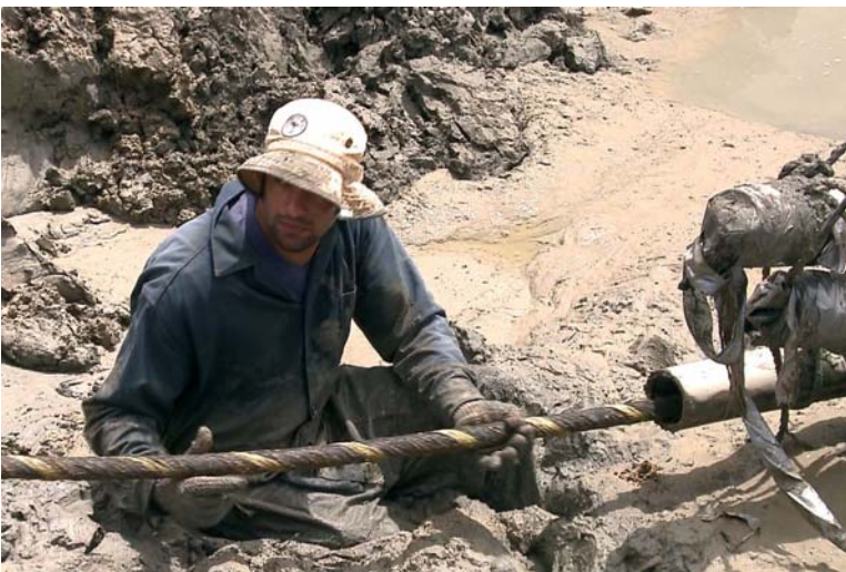
Foto: Intrede van de zeekabel in de kabelbuis
