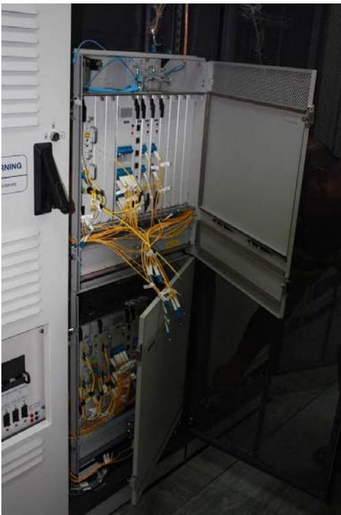
Losgetrokken kabel koppelingen en opengetrokken kasten.
